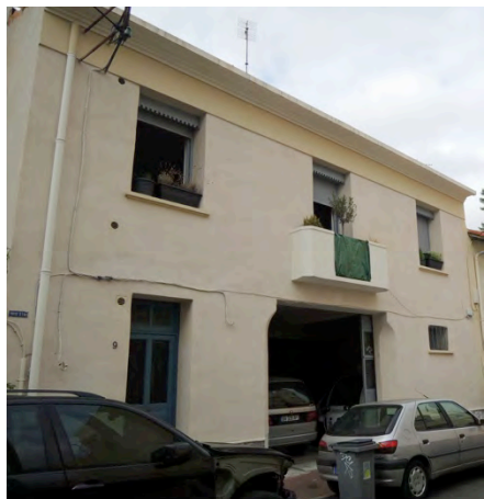
La disposition aléatoire des ventouses ou des grilles nuit à l'harmonie d'origine.
