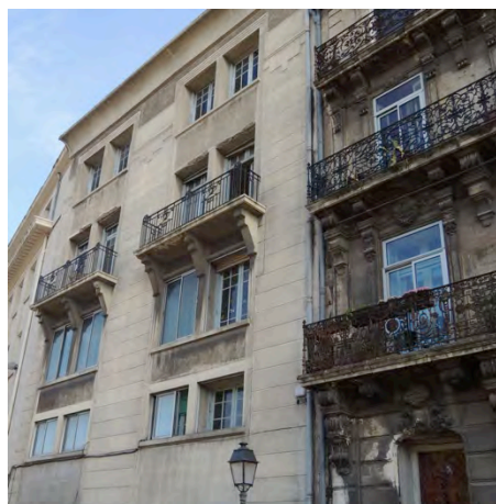
La mise en place de doubles fenêtres au nu extérieur nuit à l'harmonie d'origine
