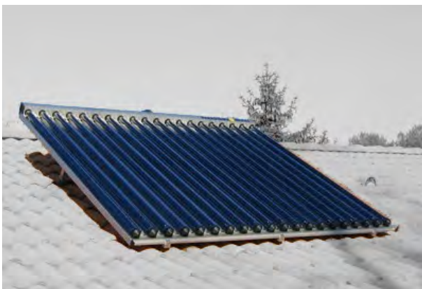
Capteurs solaires thermiques
